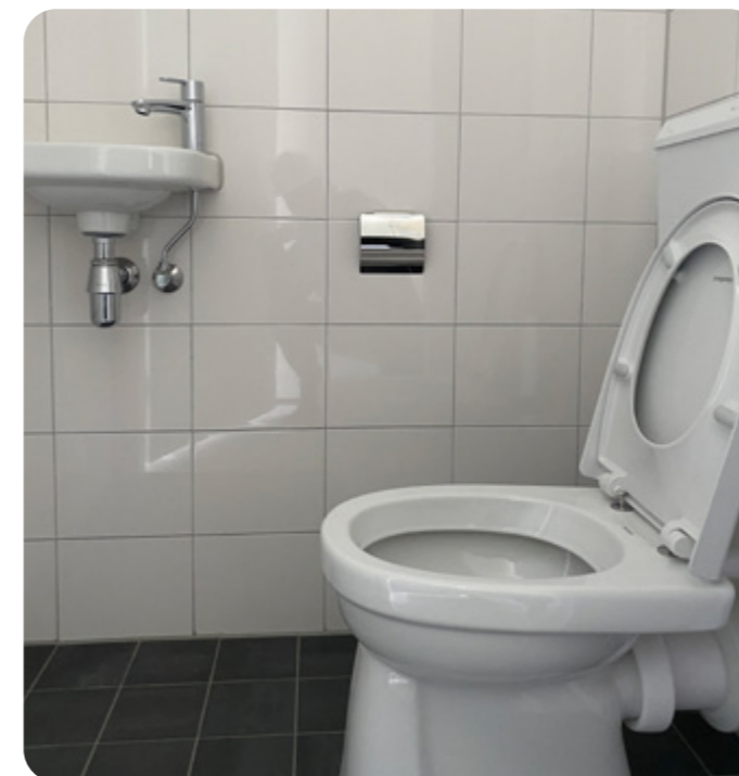
De afsluiter zit onder het fonteinpaneel.
