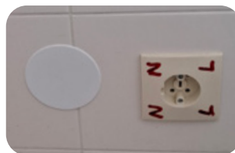
Perilexaansluiting voor elektrisch koken
